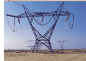
Torre de retención 500 kV en Paquistán Torre no Paquistão de LT- 500 kV
